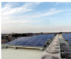
図 太陽光発電 (鹿島市役所)
