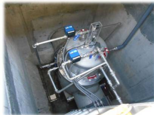
【写真 2-2 宗岡浄水場緊急遮断弁】
