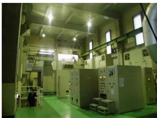
■ポンプ場建屋内
