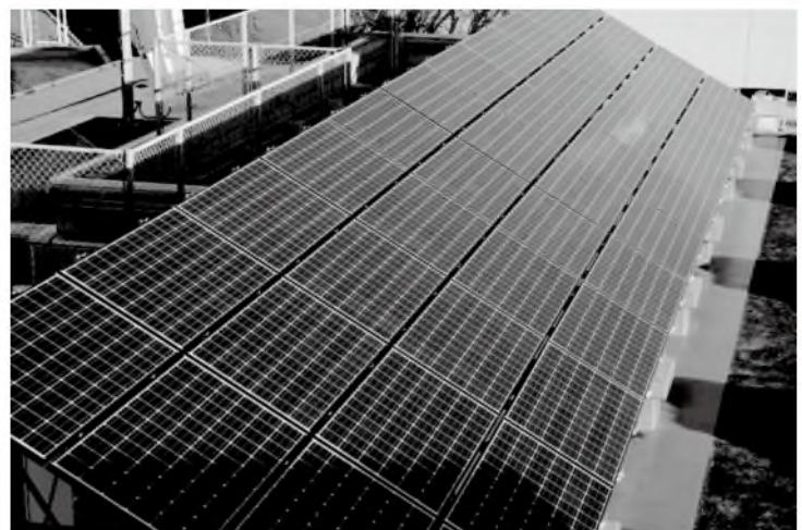
志木小学校屋上の太陽光パネル
