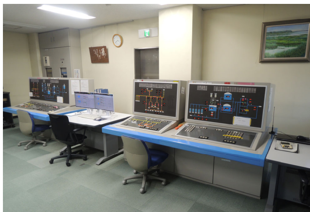
宗岡浄水場 監視室
