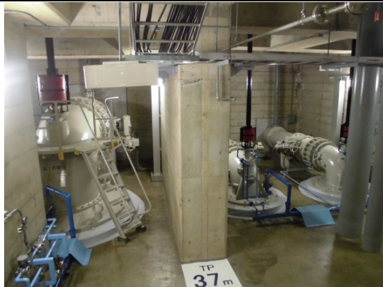
■常用（右）・非常用（左）ポンプ設備（館第一排水ポンプ場）
