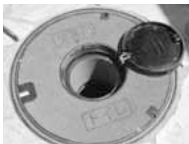
市内に設置されたマンホール用トイレ
