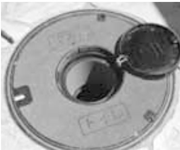
トイレとして設置可能な汚水用マンホール
