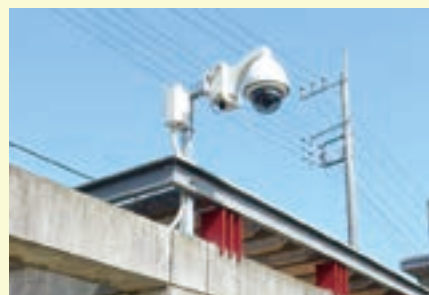
▲市内に設置している防犯カメラ
