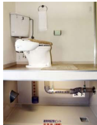
防災用便槽の一例
