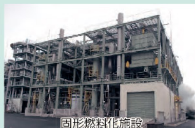
固形燃料化施設
